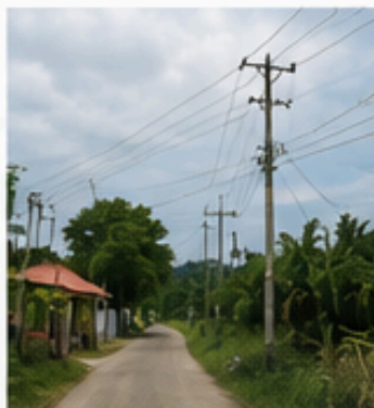
JARINGAN TEGANGAN MENENGAH
